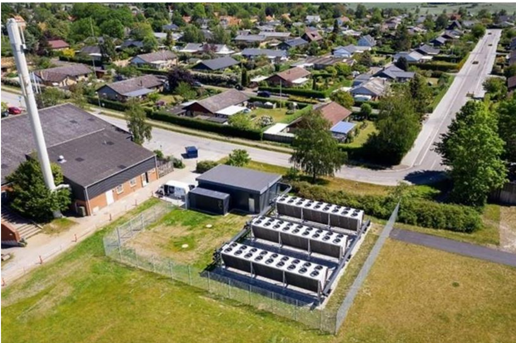
Abbildung 40: 1 MW Luft-Wärmepumpe in Slagslund Dänemark 25
