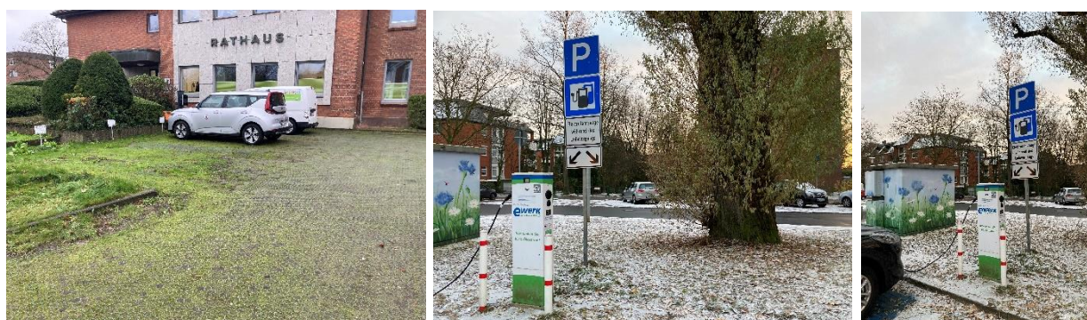
Abbildung 81: Bestand Ladeinfrastruktur (© ZEBALU GmbH)
