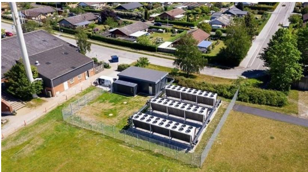
Abbildung 26: Rückkühler und Energiezentrale einer 1,2 MW Luft-Wärmepumpe in Slagslund Dänemark 19
